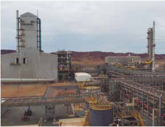
Foto del proyecto para Yara de Australia, finalizado en 2016
